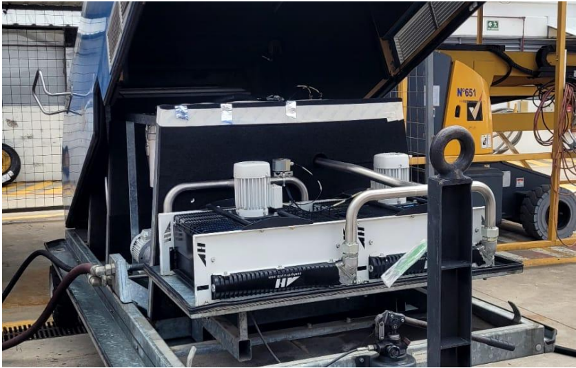
Fotografía 3. Estado superficial del exterior del equipo.
