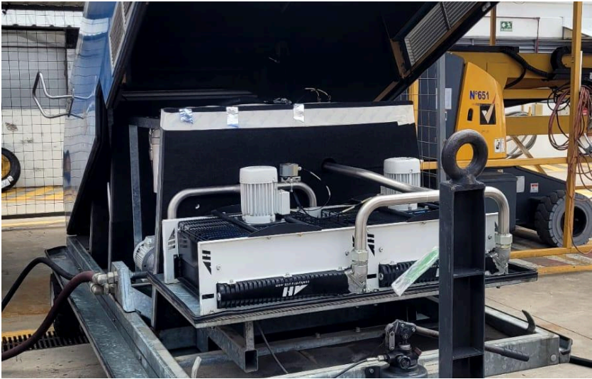
Fotografía 3. Estado superficial del exterior del equipo.
