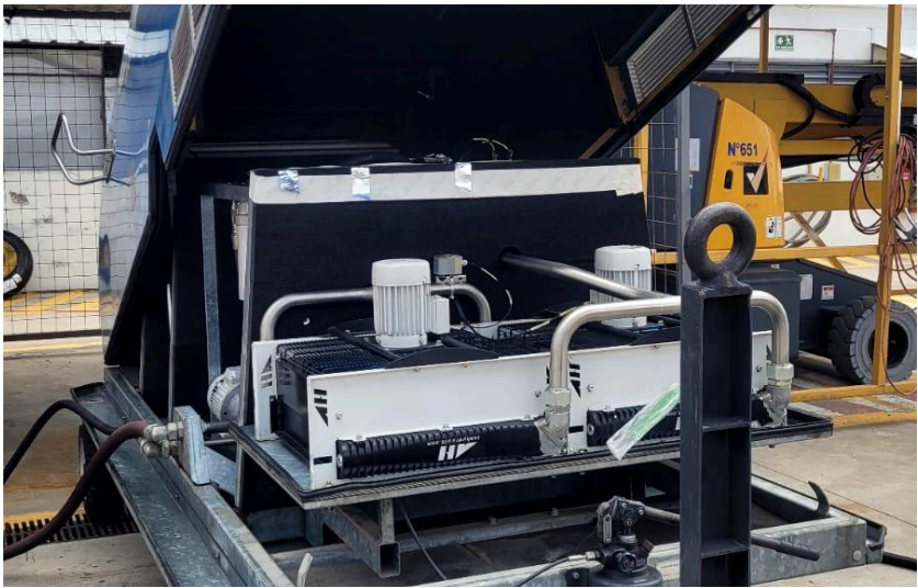
Fotografía 3. Estado superficial del exterior del equipo.
