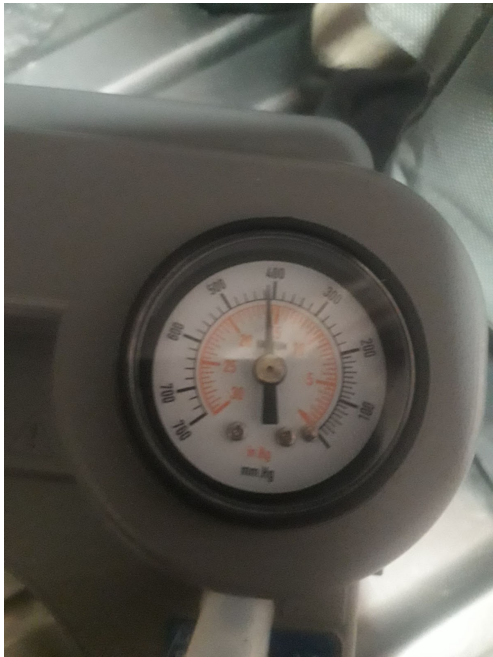
Figura 3. Manómetro en buen estado y funcionando correctamente
