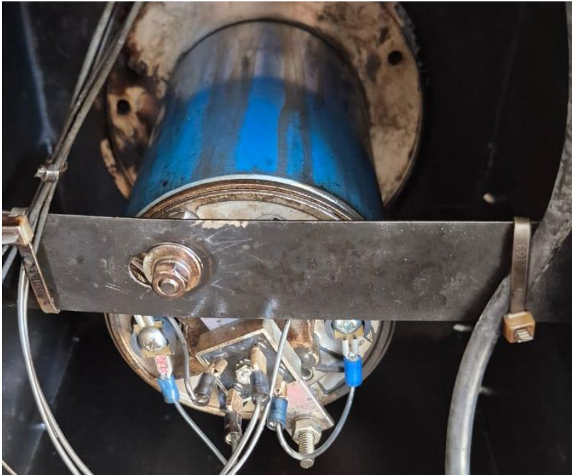
Figura 1. Estado del motor.
