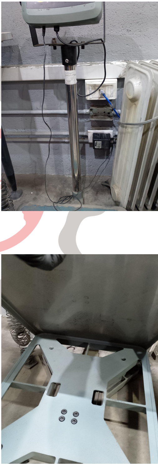
Figura 1. Mantenimiento preventivo del equipo.
