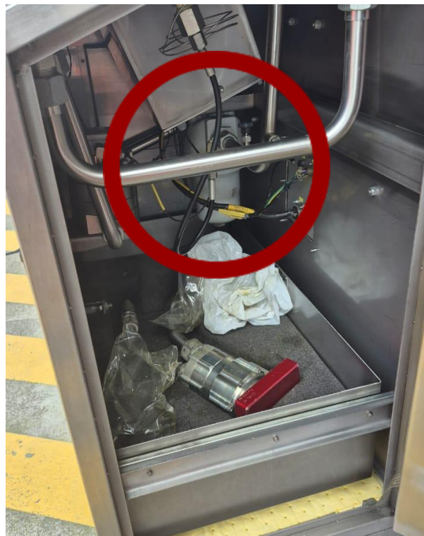
Fotografía 2. Goteo en unión de tuberías.
