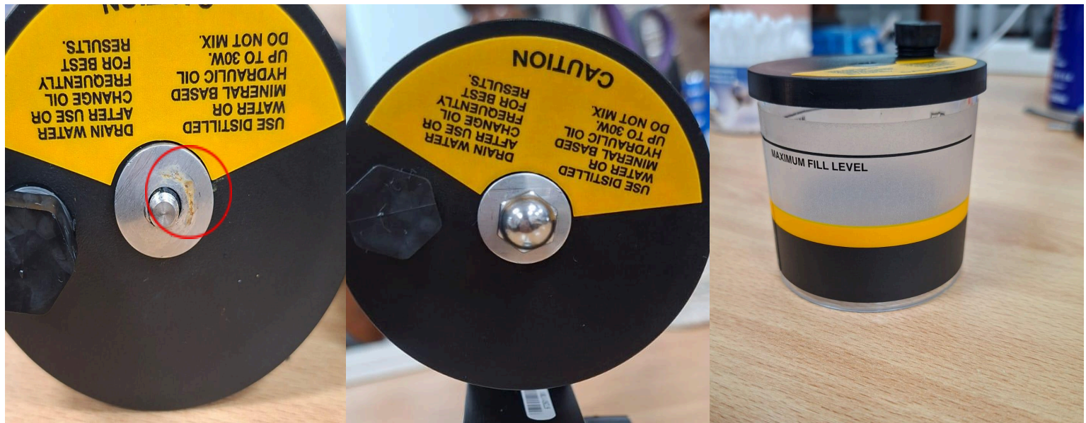
Fig. 2: Presencia de óxido antes de mantenimiento
