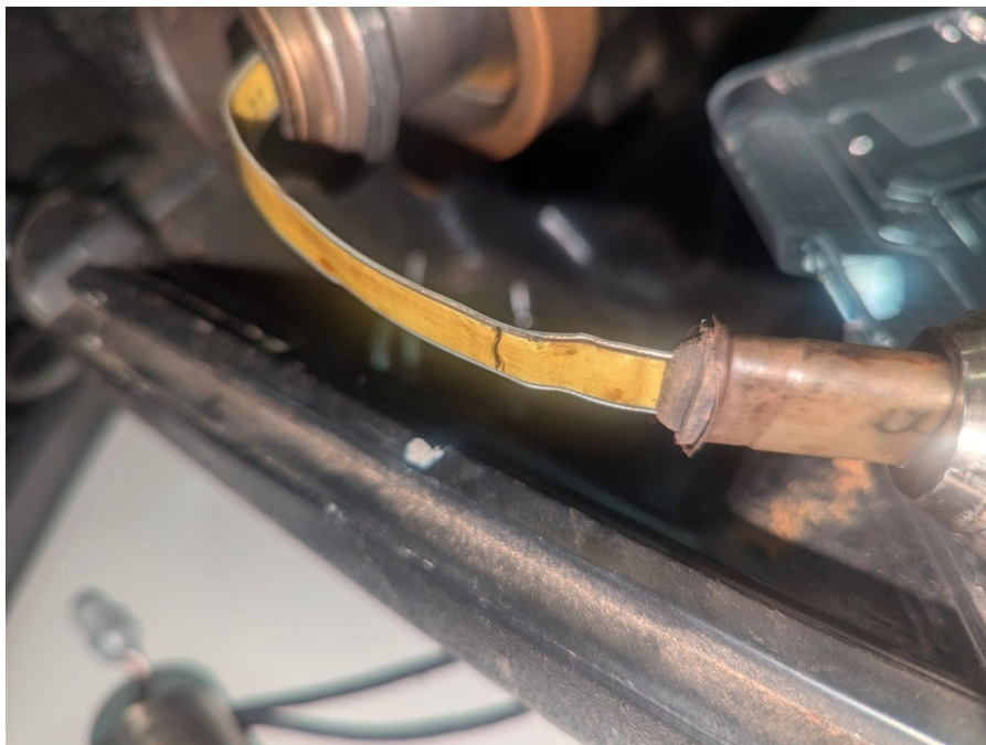
Fig 4. Punto de interrupción de señal, cable suelto
